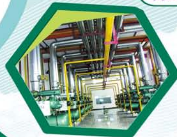
制冷美学化-设备间
